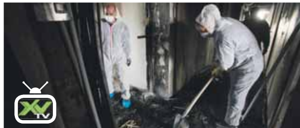
Tűzveszélyes elektromos hálózatok | Fontos az ellenőrzésük
